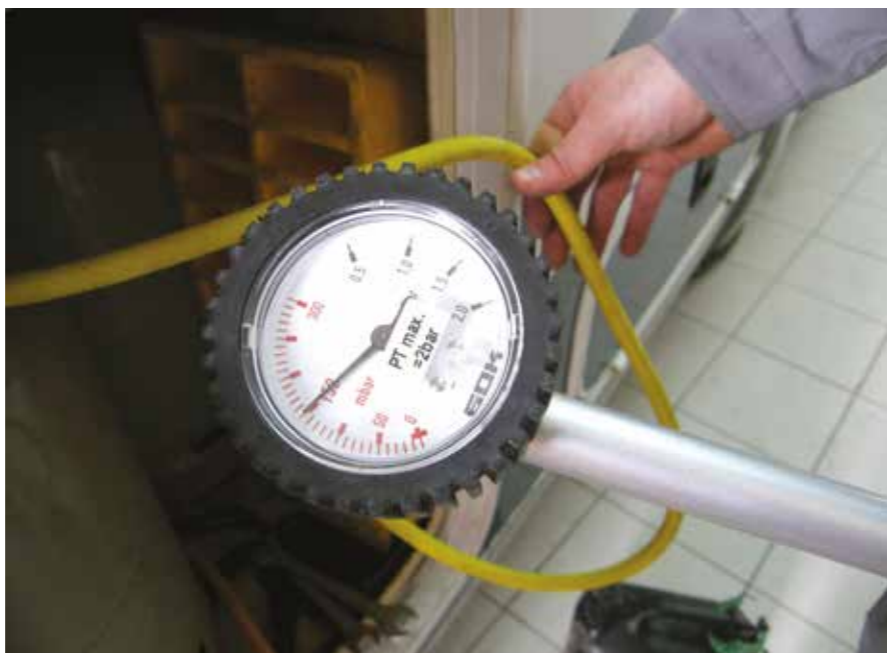
Plinsko napeljavo je potrebno redno pregledovati.
